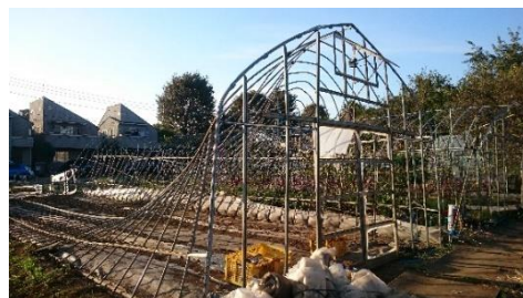
台風によって崩壊したパイプハウス
