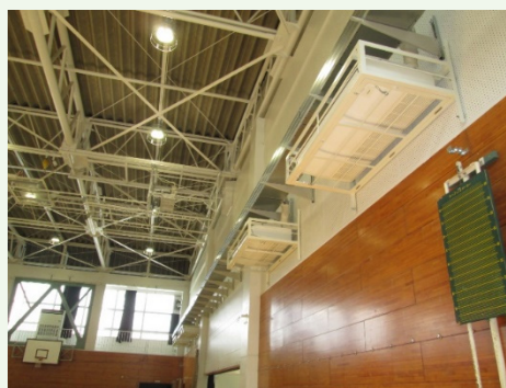
学校体育館空調設備
