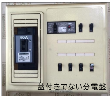
蓋付きでない分電盤
