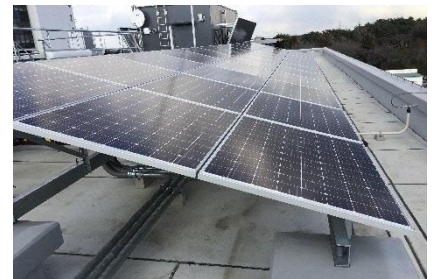
太陽光発電パネルの例
