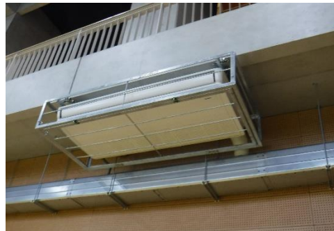
体育館エアコンの設置事例
