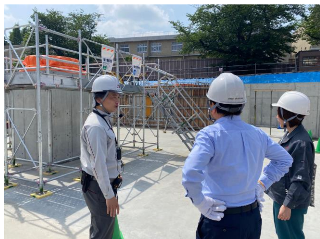
免震装置据付工事の最終日。据付済みの免震装置はオレンジ色のシートで養生されています。(5/22)
