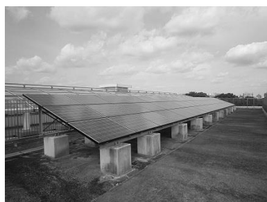
第四小学校屋上の太陽光発電
