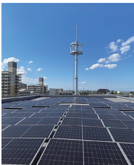
市庁舎屋上の太陽光発電設備
