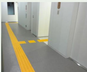
1・2階では、トイレまで誘導ブロックを敷設するとともに、音声案内で位置を誘導
